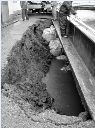
▲ 陥没した尺地川(8/29)
