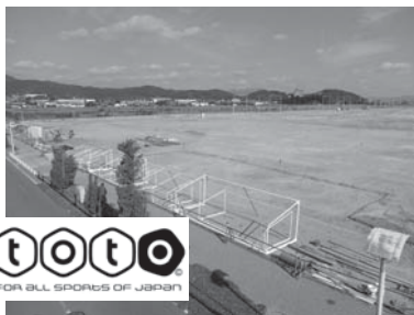
工事中の新しい海陽多目的広場 (スポーツ振興くじ助成事業)
