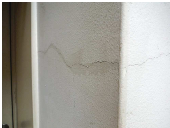
壁に入った亀裂
