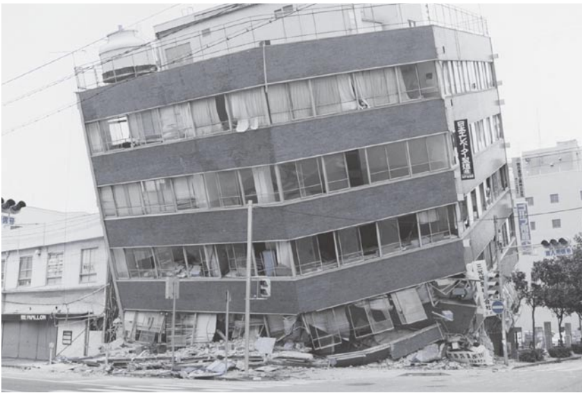
写真：阪神・淡路大震災による建物崩壊の様子（神戸市提供）
