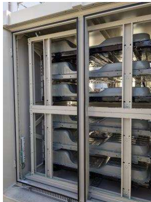
（自動車のリユースバッテリーを活用した蓄電池）
