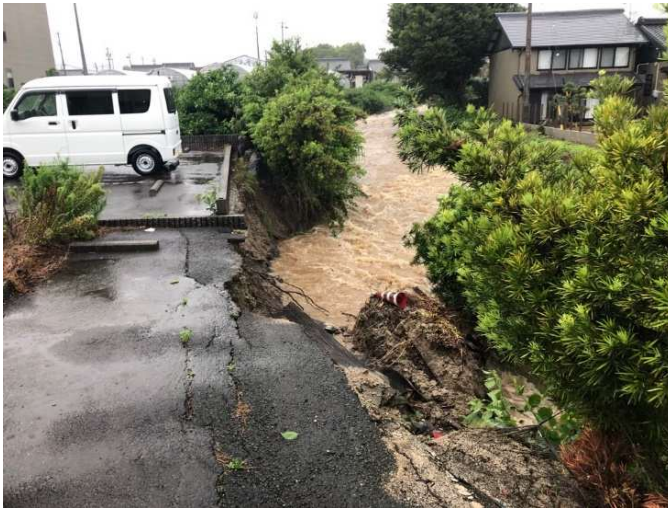
<西田川の護岸崩壊（清田町）>
