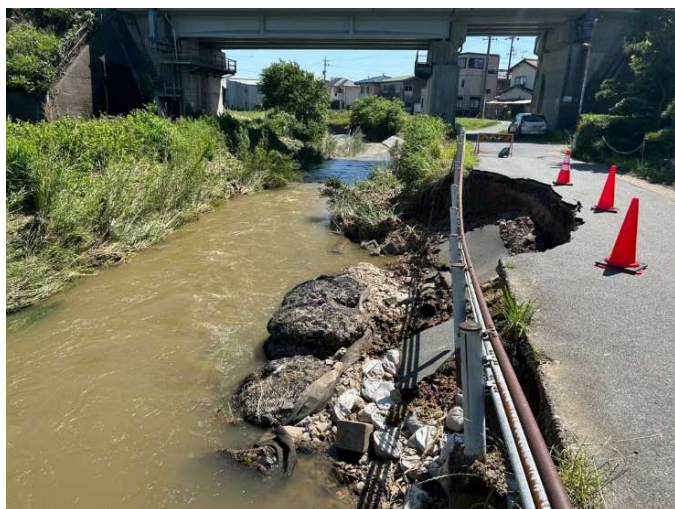
<西田川の護岸崩壊（平田町）>
