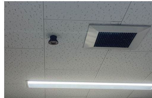
ガス系消火設備
