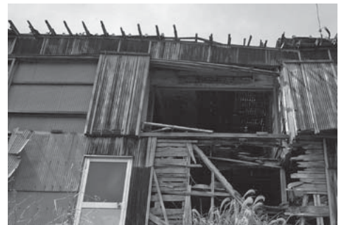
火災や倒壊が懸念される空き家
