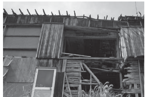
火災や倒壊が懸念される空き家
