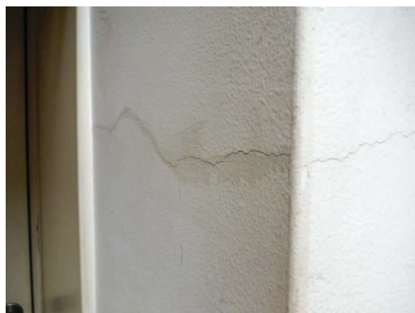
壁に入った亀裂
