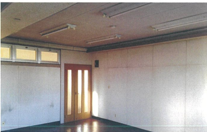
301 302号室(302号側写真) エアコンなし
