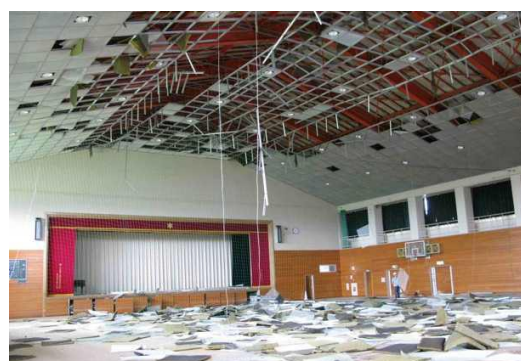
図 5.2 つり下げ天井の落下
