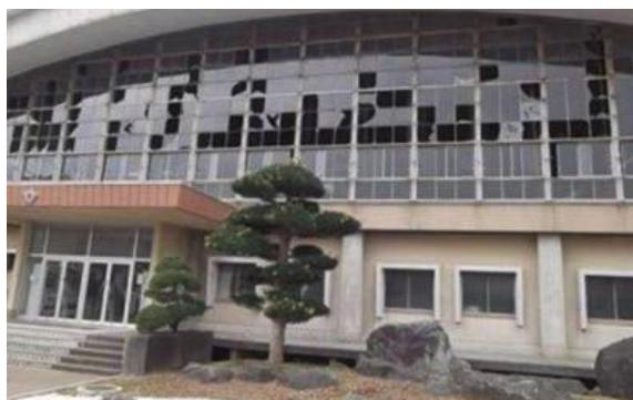
図 5.1 窓ガラスの落下
