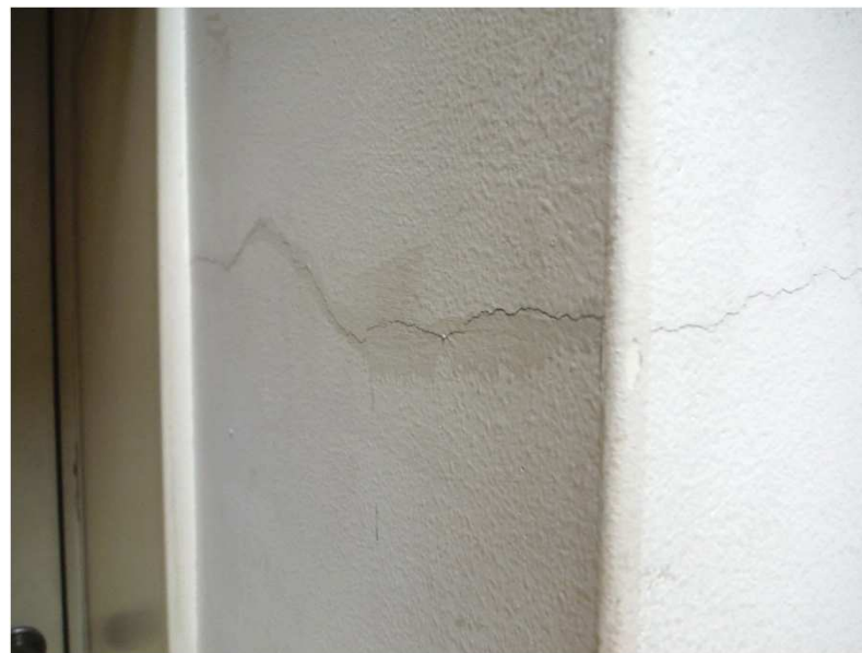
壁に入った亀裂
