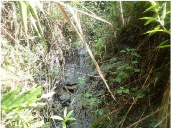
P-12 埋土平坦面からの流出状況
