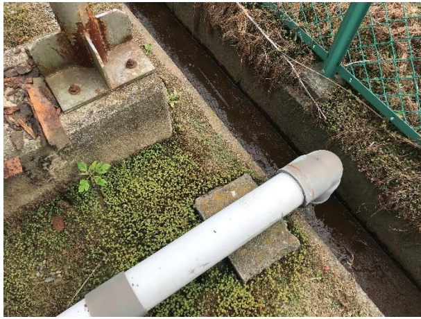
①消毒槽からU字溝への排水
