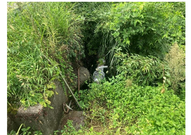
④暗渠管から排水路への排水
