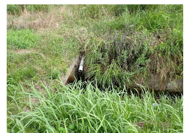
⑫水田からの排水
